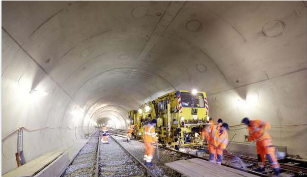
Das Bauunternehmen Leonhard Weiss gehört im Gleisbau zu den führenden Anbietern. Firmenfoto
