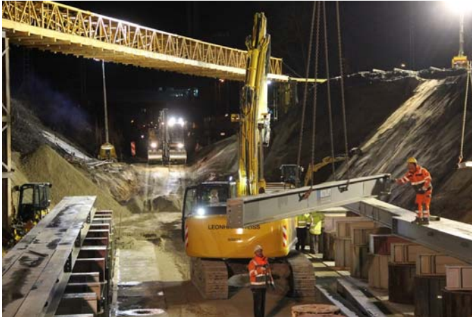
Für den Vershub wurden auf 99 m Länge Verschubbahnen verlegt – zwei parallele, eingeölte Fahrinnen aus je 9 m langen Stahlschienenstücken, in denen die Hydraulikpressen gleiten sollten. © DB AG/Hannes Frank
