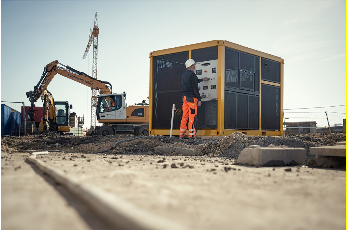
Die Smart.Energy.Box enthält auf Baustellen abgehängt und einfach zu bedienen. Foto: LEONHARD WEISS
