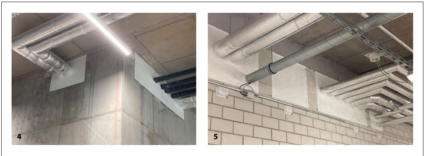
Abb. 4 und 5: Eine ordnungsgemäß installierte Anlage entsprechend der gesetzlichen Anforderungen an Brandschutz von Leonhard Weiss
